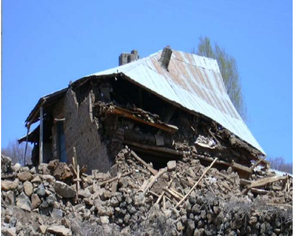
Şekil- 3.8 Yeteri kadar bileşeni olmayan yığma yapıda meydana gelen hasar.(YDGA-2005)
